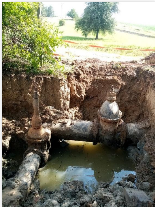
Fotografia č. 9: Pôvodné uzatváracie armatúry zdroj: Hydromeliorácie, štátny podnik
