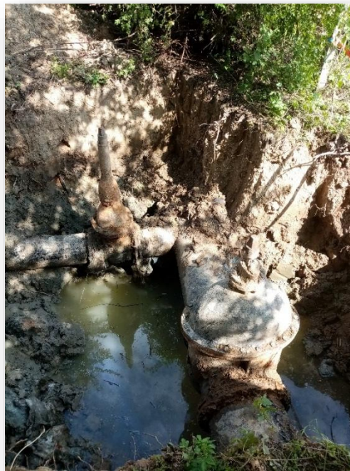
Fotografia č. 10: Pôvodné uzatváracie armatúry zdroj: Hydromeliorácie, štátny podnik
